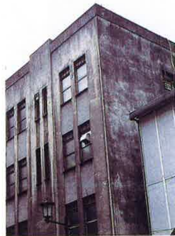
ビル外壁部の汚れ
