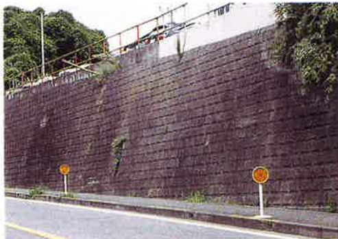
コンクリート擁壁部の汚れ
