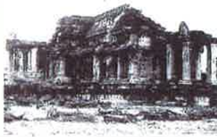
アンコール・ワット外周壁内の北縁部分。地衣類や藍藻（らんそう）類による黒染が著しい。この付近で薬剤の効果をためす実験をした。新井英夫氏提供
